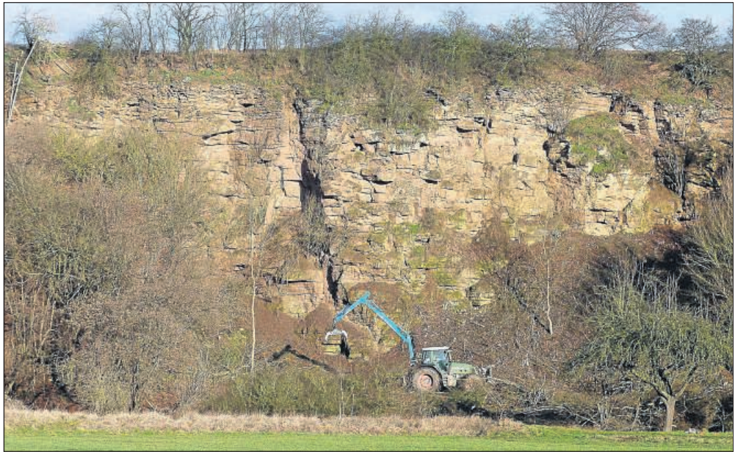
Spezialmaschinen im Einsatz: Die eindrucksvolle Bergflanke wurde wieder freigeschnitten. Der NABU Edertal stand bei den Arbeiten beratend zur Seite.
