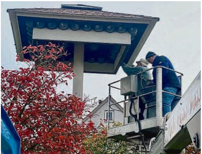
Hubsteiger im Einsatz: Im Bild Reinigungsarbeiten am Schwalbenhaus der Familie Strasser in Affoldern. FOTO DREHER/PR
