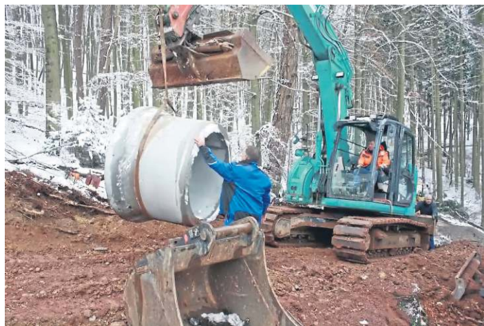
Winterbaustelle: Die Firma Brede bei der Befestigung des Stolleneingangs zum Fledermausstollen am Kupferberg.
