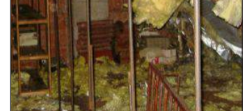
Schäden durch Waschbären unterm Dach: In diesem Walddauer Haus in Kassel haben die Tiere die Dämmung zerstört.
